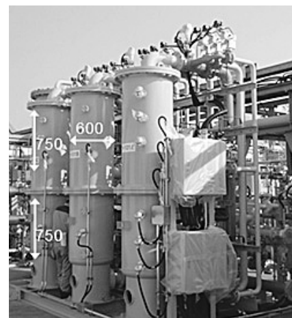
写真2 二段吸着塔外観写真
